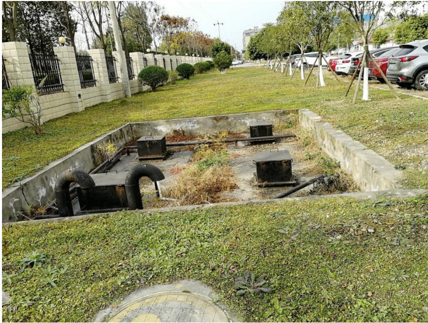
地埋式污水处理设施
